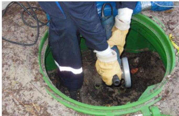
Position du technicien lors de l'accident
